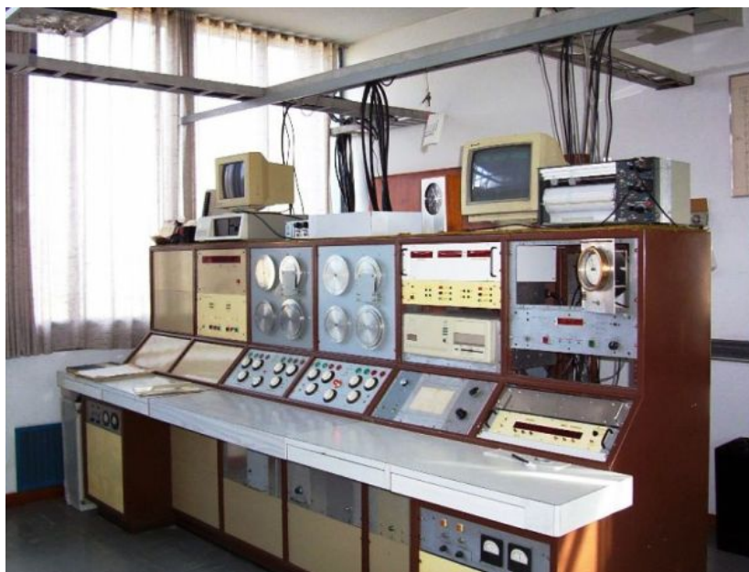
Sala de control - IAR
